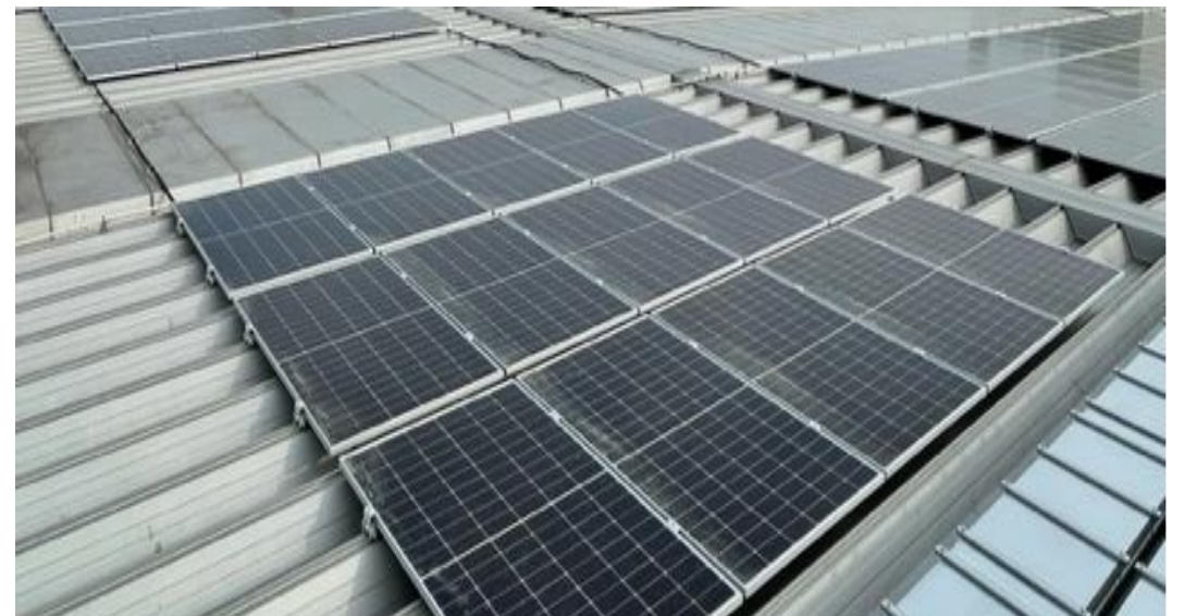
屋根に太陽光発電パネルが設置されたイオン小郡店
